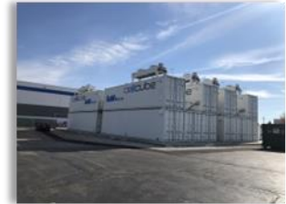
G&W Electric (2022) Bolingbrook, IL
